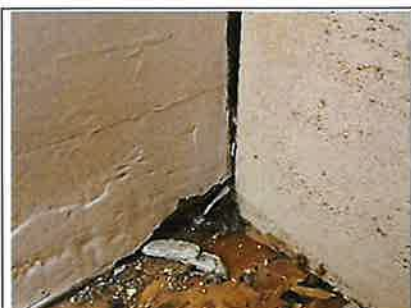
Photo n° PhTer001 Localisation : 1er étage - Cuisine Ouvrage : Fenêtre 3 - C - Bois et Peinture Parasite : Présence d'indices d'infestation de termites Indices : altérations dans le bois (présence sur une partie de l'élément)
