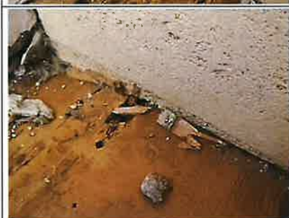
Photo n° PhTer002 Localisation : 1er étage - Cuisine Ouvrage : Marche sous fenêtre 3 - C - Bois et Vernis Parasite : Présence d'indices d'infestation de termites Indices : altérations dans le bois (présence sur une partie de l'élément)
